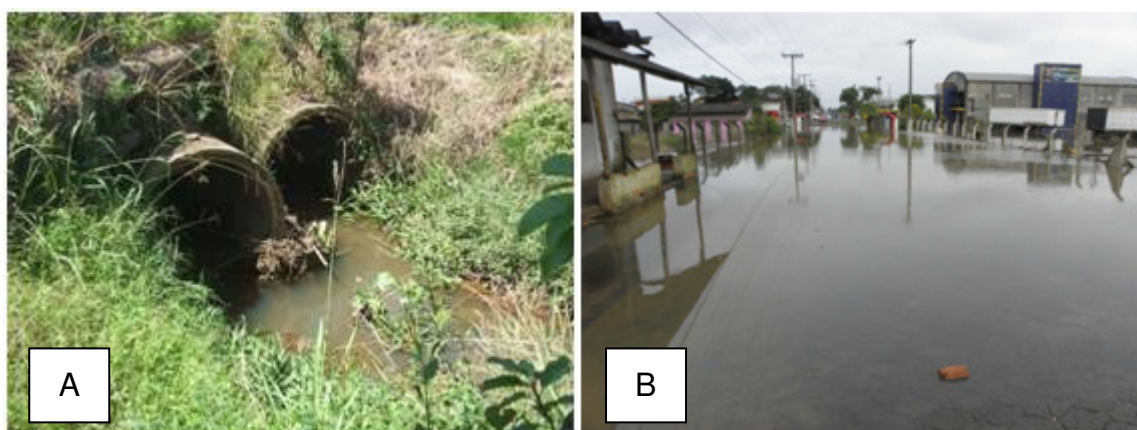
Figura 20 – A) Macrodrenagem sob a rua Francisco Ronchi, fevereiro de 2010; B) Mesmo local alagado após precipitações intensas ocorridas em maio de 2010.
