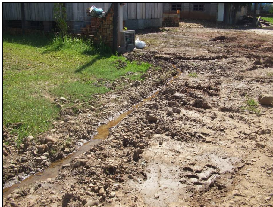
Figura 22 - Ocorrência de esgotamento a céu aberto no Loteamento Barbieri, Março de 2010.
