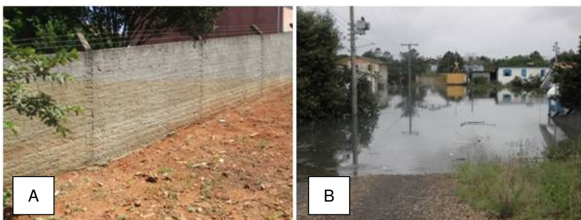
Figura 18 – A) Comparação da marca do nível d’água em épocas normais em um muro localizado no bairro Nova York em fevereiro de 2010; B) No detalhe, mesmo local após inundação ocasionada pelo rio Sangão, em maio de 2010.
