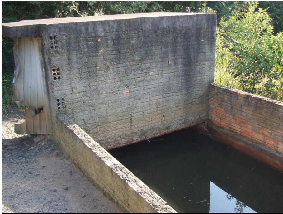
Figura 31 – Estação desativada de coleta e recalque de chorume para tratamento. Forquilha, abril de 2010.
