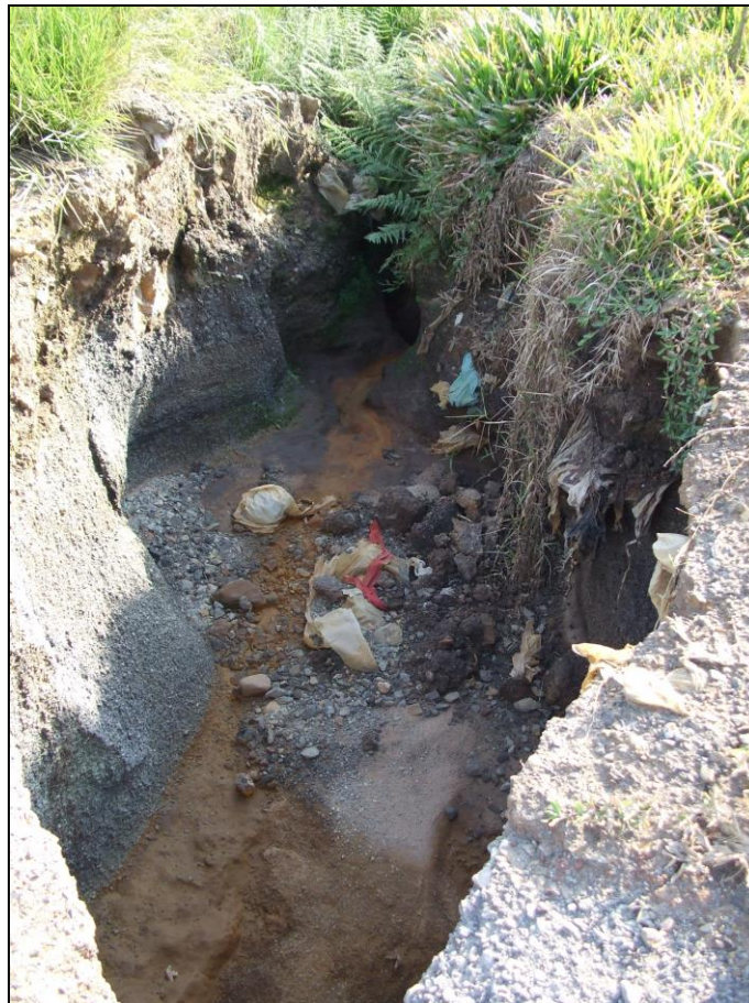
Figura 30 – Voçoroca provocada pela drenagem de chorume percolado das pilhas de resíduos. Forquilha, abril de 2010.
