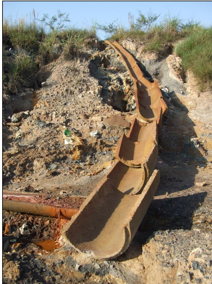
Figura 26 – Vista de um talude que foi “coberto” por argila, apresentando rejeitos piritosos e resíduos descobertos. No detalhe, uma canaleta de drenagem superficial danificada. Forquilha, abril de 2010.
