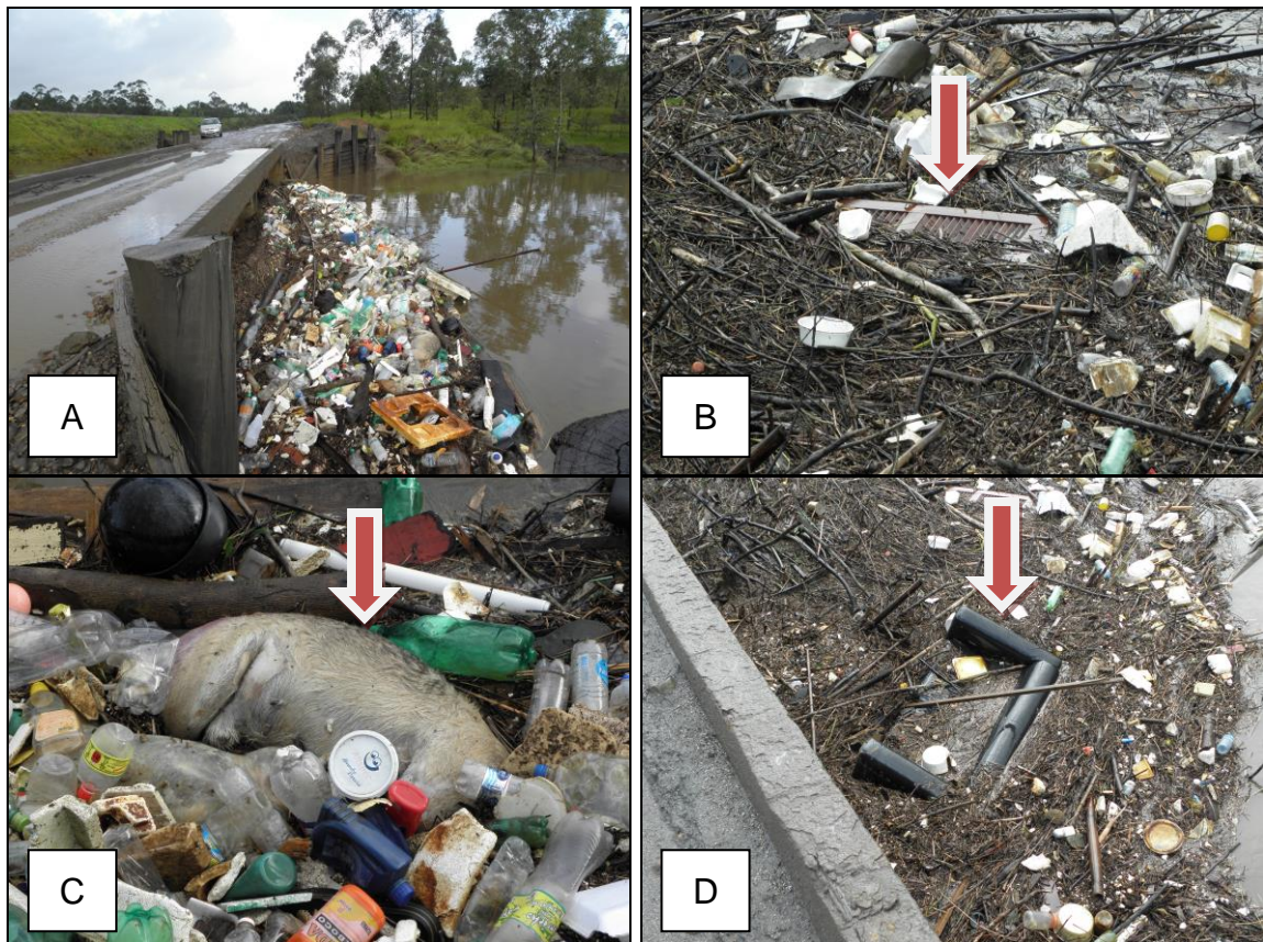
Figura 20 – A) Detalhe do represamento de resíduos sólidos na ponte que faz divisa entre Criciúma e Forquilha no bairro Santa Líbera; B) Detalhe de galharias, janela e plásticos; C) Detalhe de animal morto; D) Detalhe de sofá. Maio de 2010.
