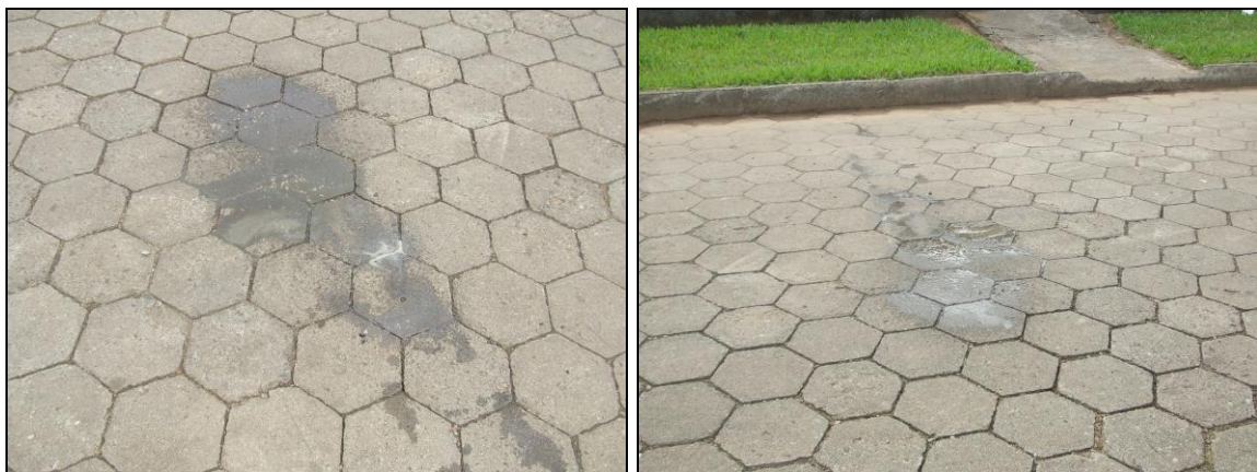
Figura 10 – Líquido (chorume) derramado pelo caminhão coletor na Rua Maria de Lourdes Fernandes da Silva, Bairro Ouro Negro, Março de 2010.
