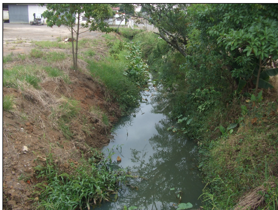
Figura 4 – Drenagem pluvial contaminada com esgoto sanitário. Bairro Ouro Negro, Forquilha, março de 2010.
