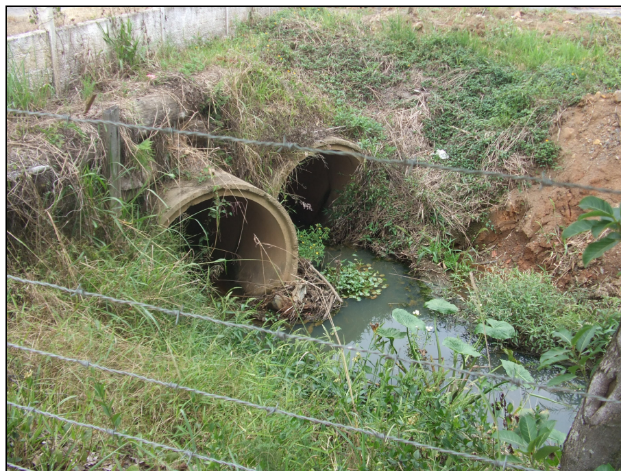
Figura 3 – Drenagem pluvial contaminada com esgoto doméstico. Bairro Ouro Negro, março de 2010.
