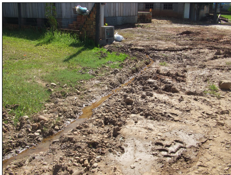
Figura 15 - Ocorrência de esgotamento a céu aberto no Loteamento Barbieri, Março de 2010.
